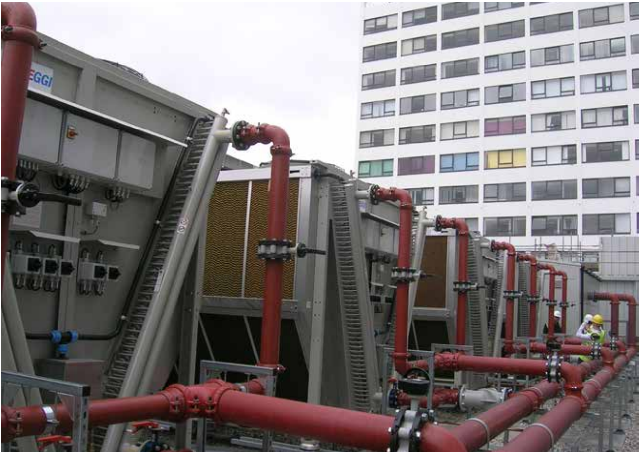
ADC-Kühler zur Gebäudeklimatisierung in London Foto: JAEGGI Hybridtechnologie AG
