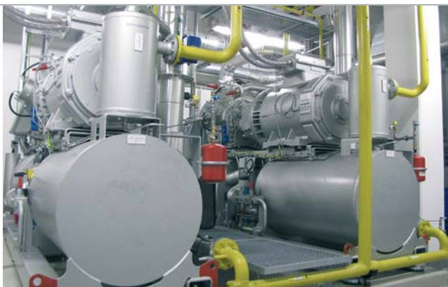
Ammoniak-Kälteaggregat im Maschinenraum
