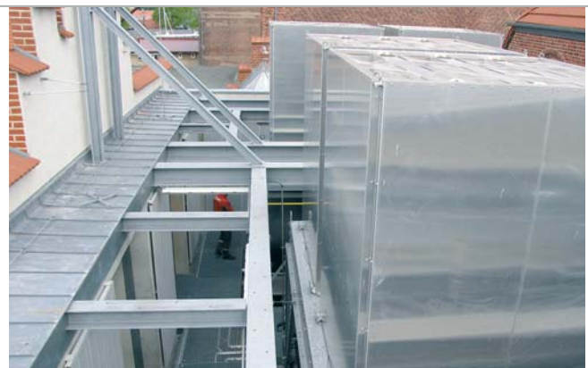
Zusätzliche Abluftschalldämpfer erreichen die sehr hohen Schallanforderungen der Planung
