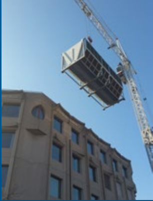
▲ Ein Kran hievt einen rund 4.600 kg schweren JAEGGI ADC auf das Dach des Verwaltungsgebäudes von DuPont de Nemours.
