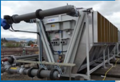
▲ Vier JAEGGI ADC kühlen das EMEA-Hauptquartier am Genfer See in der Schweiz.
