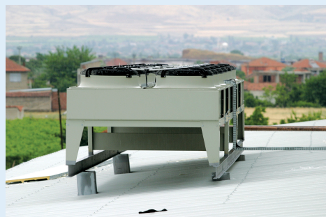
Güntner Verflüssiger Axial GVH: Trotz Außentemperaturen von 34 °C bringen Güntner Verflüssiger ausreichend Verflüssigungsleistung und Güntner Verdampfer im Innenraum eine relative Feuchte von 98 %.
